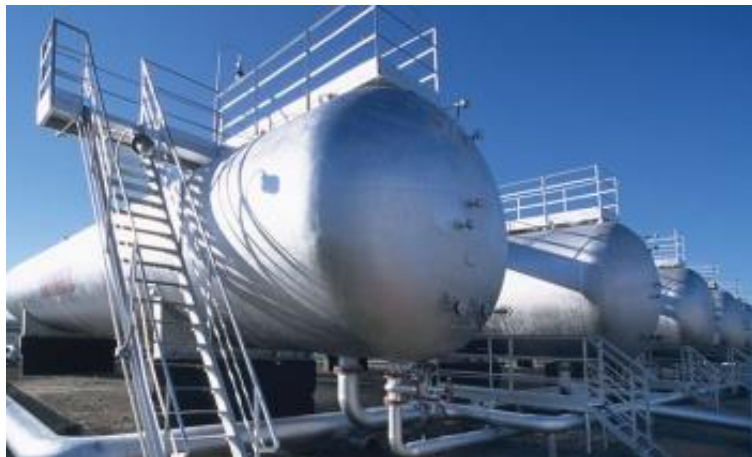
Сосуды и трубопроводы
